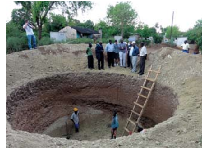
Construcción de letrina de biogás que forma parte de las obras iniciadas por el Fondo Fiduciario para la Delegación de Competencia en Libuyu, Livingstone (Zambia). Noviembre de 2011. FOTOGRAFÍA: PHILIPP FEIEREISEN, GIZ
